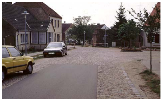
Bild 4.9: Falsch eingesetzter Pflasterbelag
